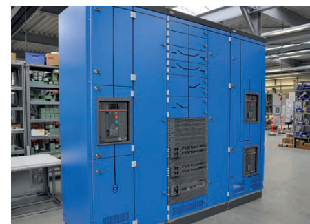
Schaltanlage System GNS 5.1
