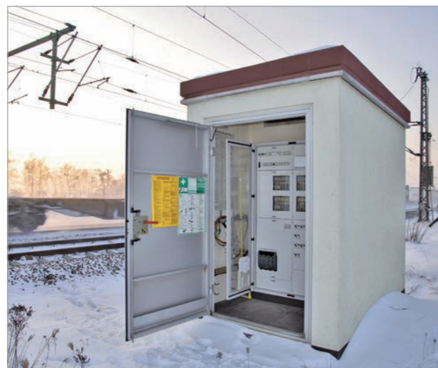
Fertigteilbetonstation BS 180 mit eingebauter Weichenheizungsverteilung
