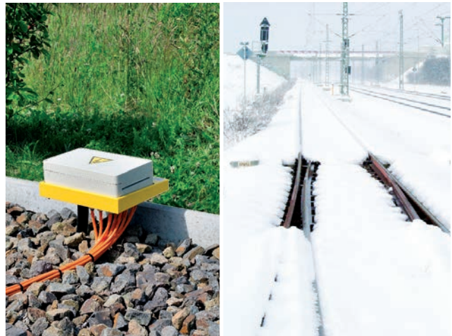
Anschlusskasten mit RCM – Isolationsfehlersuchgerät und beheizte Weiche bei Schnee
