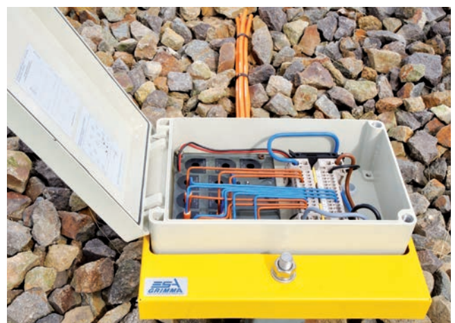
Anschlusskasten mit Isolationsfehlersuchgerät RCM
