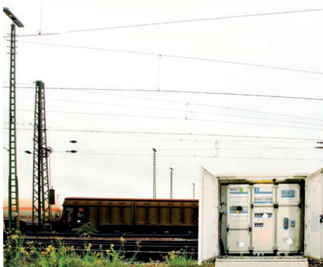
Gleisfeld-Beleuchtungsverteilung auf einem Rangierbahnhof in Mannheim
