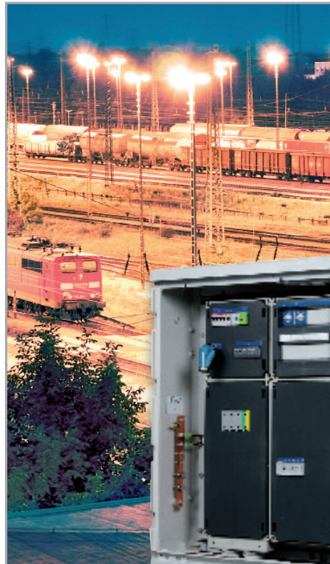
Rangierbahnhof in Mannheim Gleisfeld-Beleuchtungsverteilung mit Steuerung
