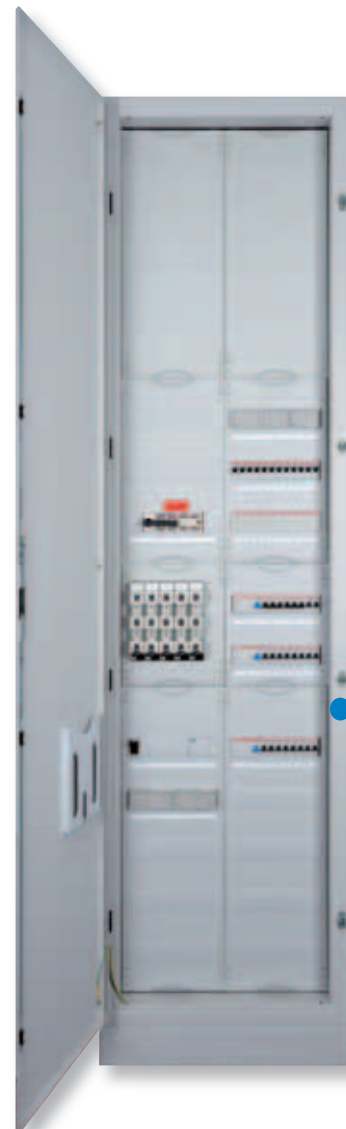
Beispiel Verteiler mit dem Schaltanlagen System GIV und MPM 12-2 der ESA-Grimma
