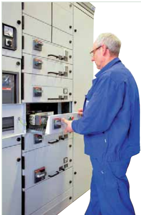
Wechsel eines Volleinschub-Moduls im Schaltanlagen-system GNS 3.1
