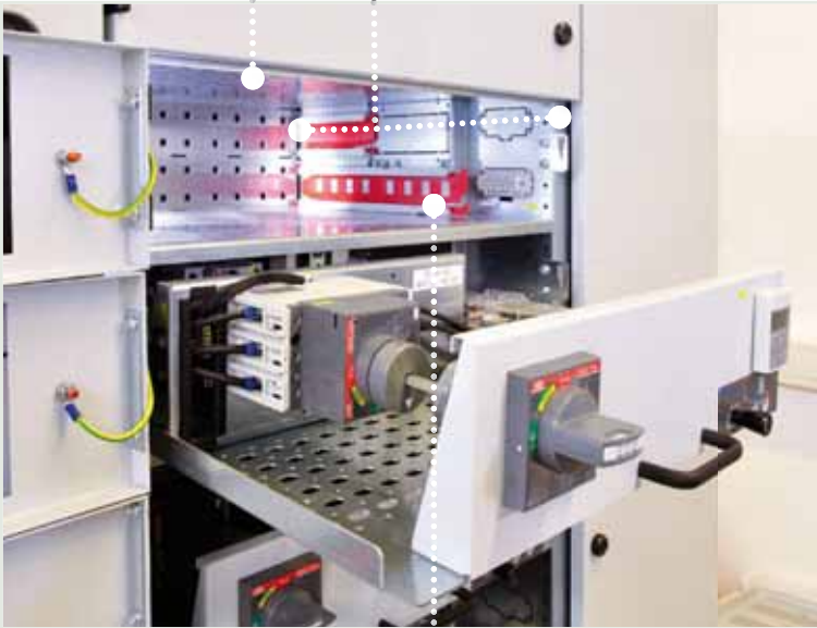
Einschubfächer – Blick auf Systemwand, Zuführung Volleinschub-Modul 9 E
