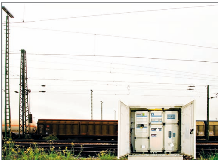
Gleisfeld-Beleuchtungsverteilung auf einem Rangierbahnhof in Mannheim
